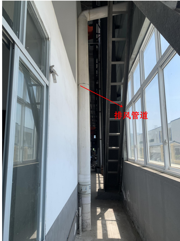
图 3-6 本项目探伤室排风管道照片
