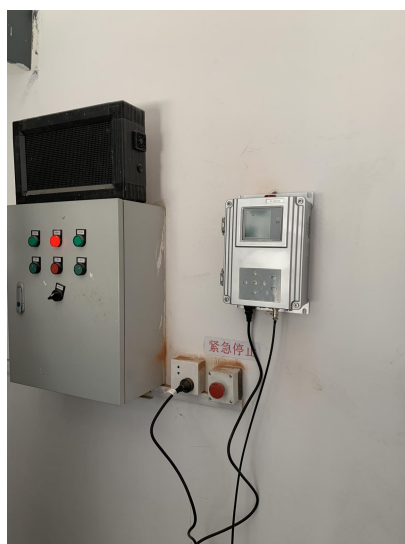
迷道防护门外紧急停止按钮及固定式辐射监测仪
